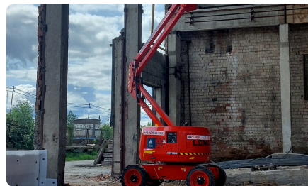
Коленчатый на металлоконструкциях
